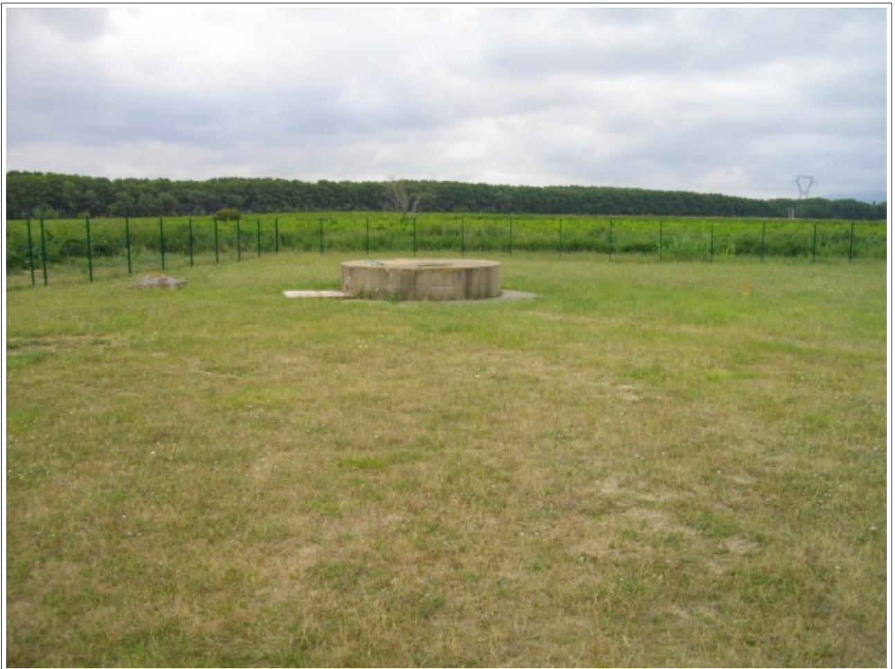
Azille, captage d'eau du puits des Fans
